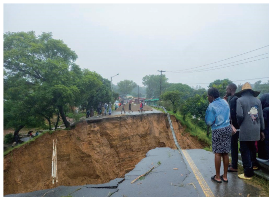
■ 图片来自新华社：3 月 14 日，在马拉维南部的布兰太尔地区，人们查看被洪水冲毁的道路
